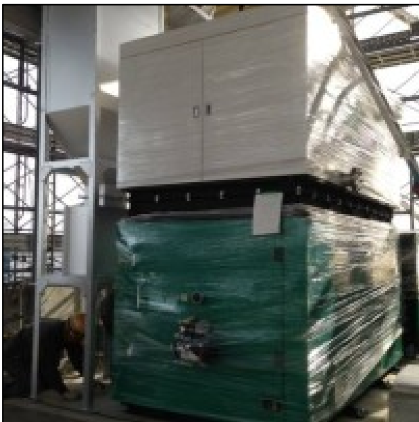
木質チップ焚ボイラ（定格：500kW） 85℃の温水を製造
